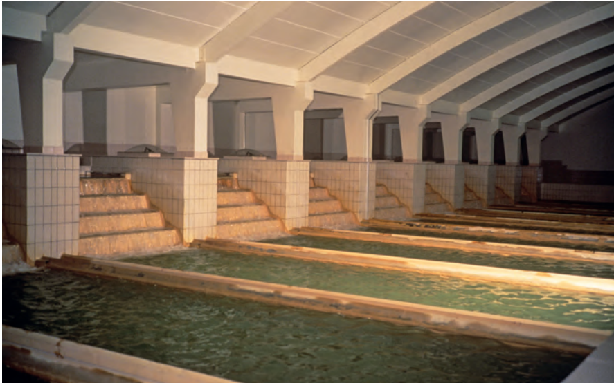
İçme suyu arıtma
