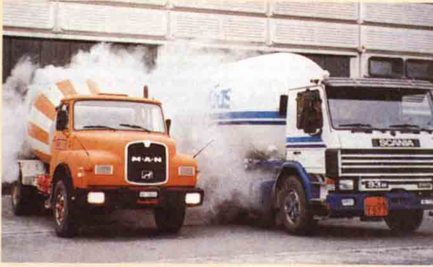
Sıvı azotla soğutulan beton daha az çatlar.
