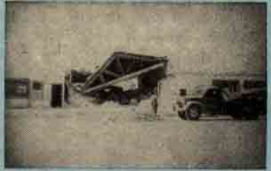
ŞEKİL : 4 Hindistan'daki 1967 Koyne depreminde çatı makası taşıyan bir konstrüksiyonun rijit bağlantı yerinden koparak çökmesi.
